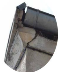
10 Élément de corniche instable
