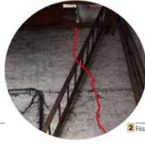
2 Fissures du clocher
