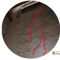
1 Fissures du clocher
