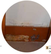
2 Décollement des badigeons.
